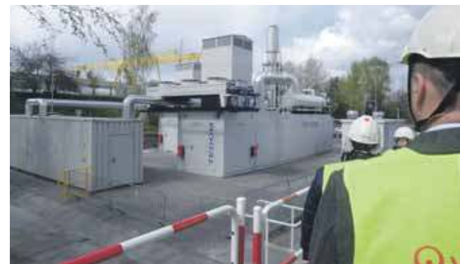
Zespół kogeneracyjny o mocy 0,99 MWe jest zasilany gazem ziemnym i biogazem wyprodukowanym w lokalnej oczyszczalni ścieków
