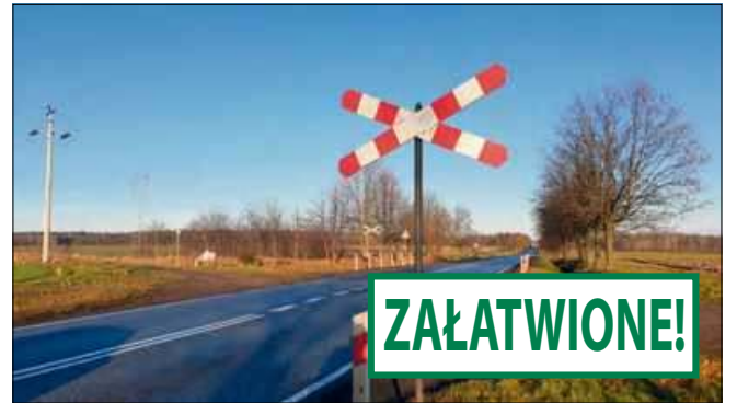
Szyna na przejeździe została naprawiona.
