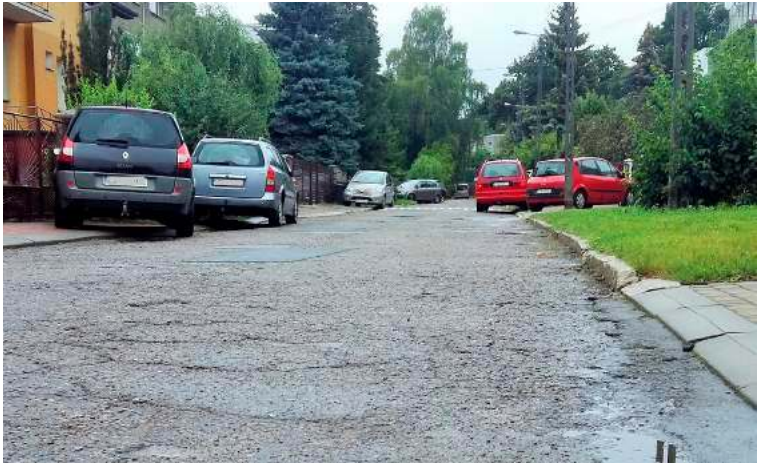
Ulicy Zuchów na pewno przydałby się remont, ale nie brakuje głosów, że inne ulice wymagają pilniejszej naprawy
