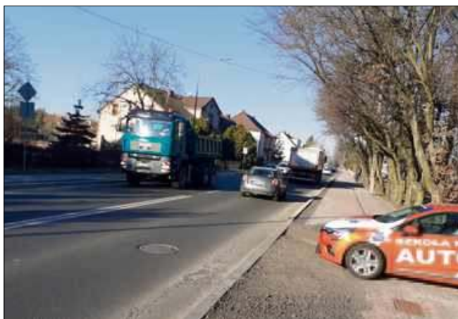
W niektórych miejscach prace wyglądają na niedokończone.
