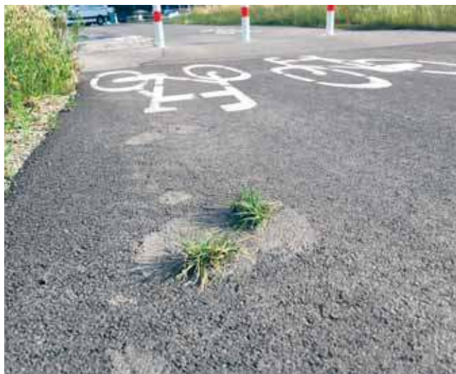
Kępki trawy wyrastające z nawierzchni ścieżki rowerowej w sąsiedztwie ronda ks. kpt. Wilhelma Stempora
