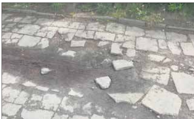
Czy zdemastowany chodnik doczeka się remontu?
