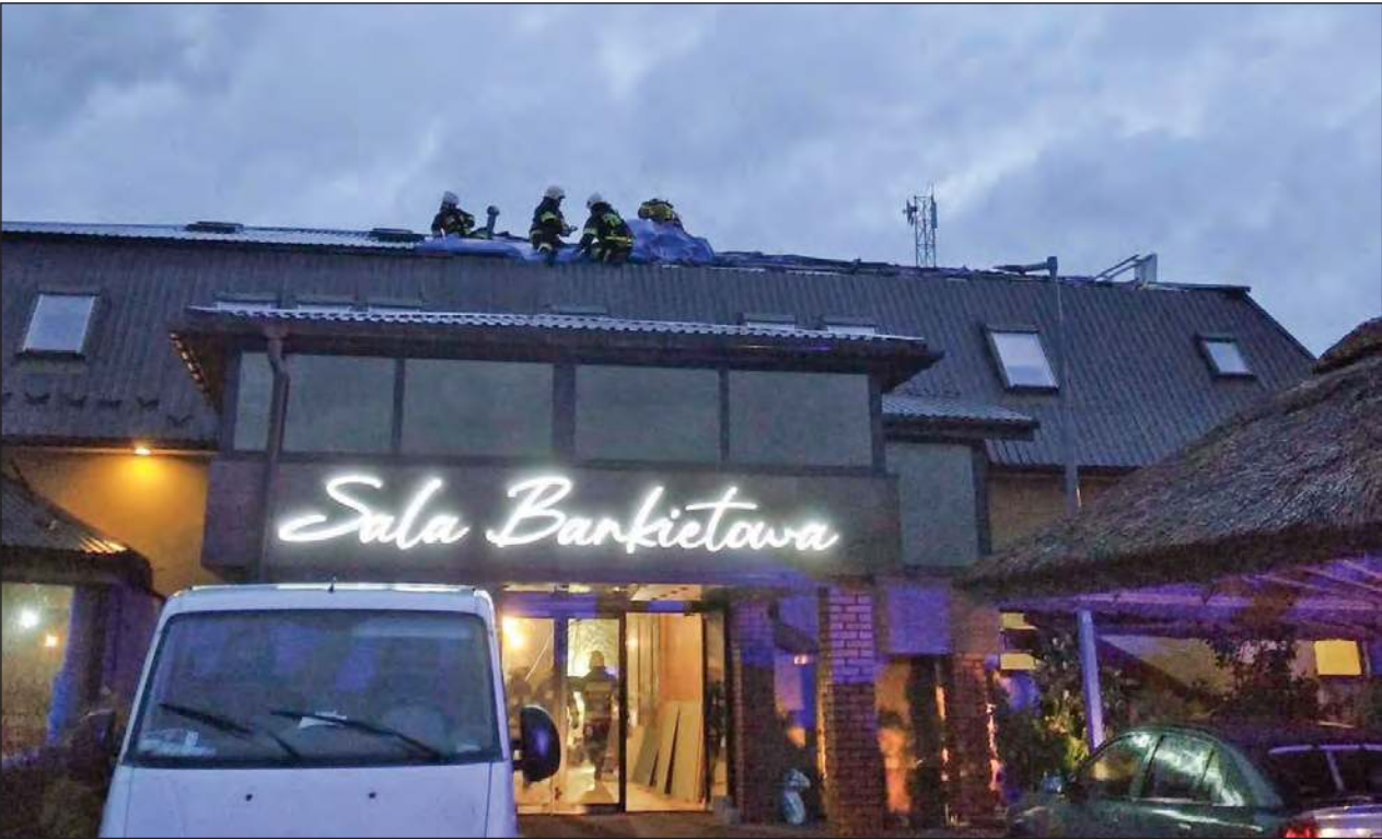
MROKÓW Silny podmuch wiatru w czwartek 17 lutego poderwał fragment dachu na budynku restauracji i sali bankietowej w Mrokowie (gm. Trojanów). Z zagrożeniem przez kilka godzin walczyli strażacy z dwóch jednostek OSP: Wola Korycka i Korytnica. Budynek udało się zabezpieczyć plandeką i łatami budowlanymi
