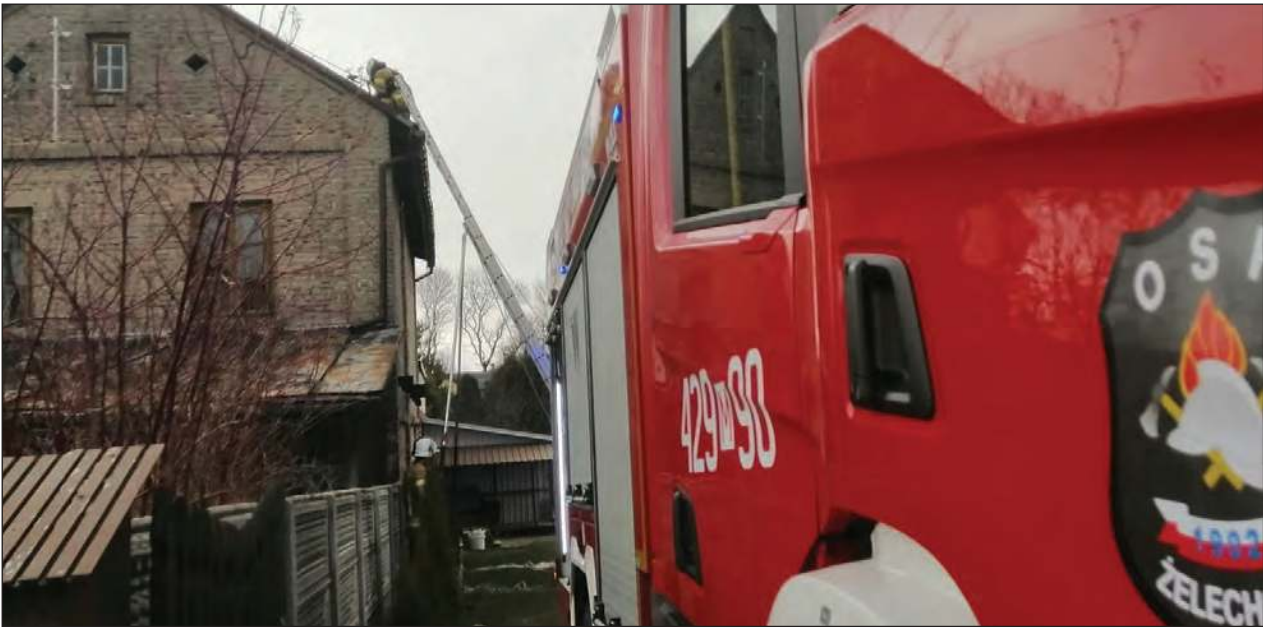
ZELECHÓW W sobotę wczesnym przedpołudniem porywisty wiatr naruszył konstrukcję dachową budynku mieszkalnego przy ul. Długiej. Zagrożenie zostało zabezpieczone. W akcji brały udział dwie jednostki gminnej OSP: Żelechów i Wola Żelechowska
