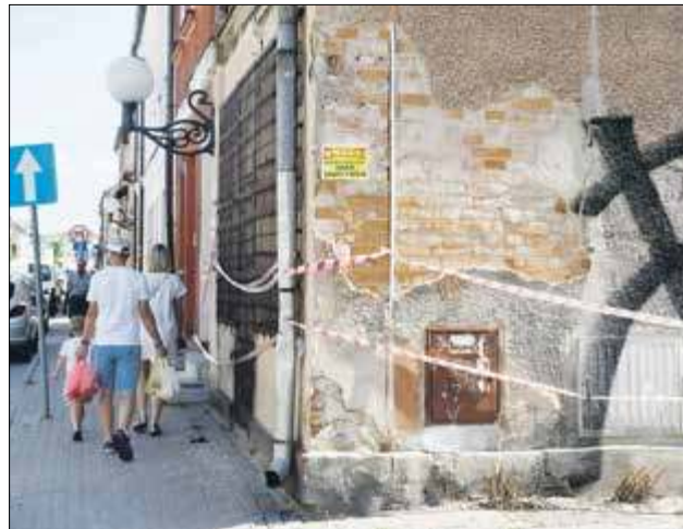
Budynek, na którym wisi ostrzeżenie o groźbie zawalenia został opasany taśmą. Jak informuje magistrat, właściciel nie otrzymał zgody na rozbiórkę
