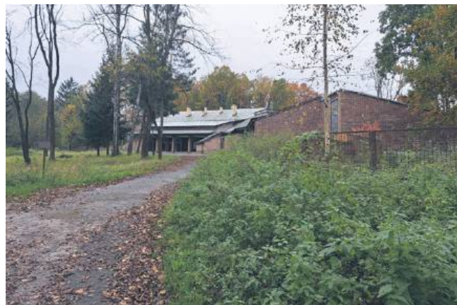
Budynek potrzebuje gruntownego remontu.
