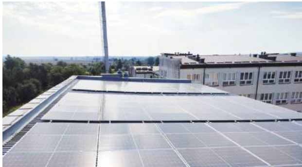
Instalacja fotowoltaiczna na dachu Zespołu Szkół w Turobinie.
