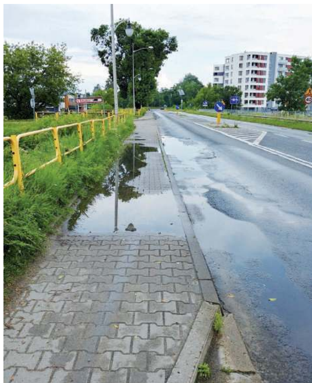
Ulica Morawicza, która wymaga poprawy nawierzchni
