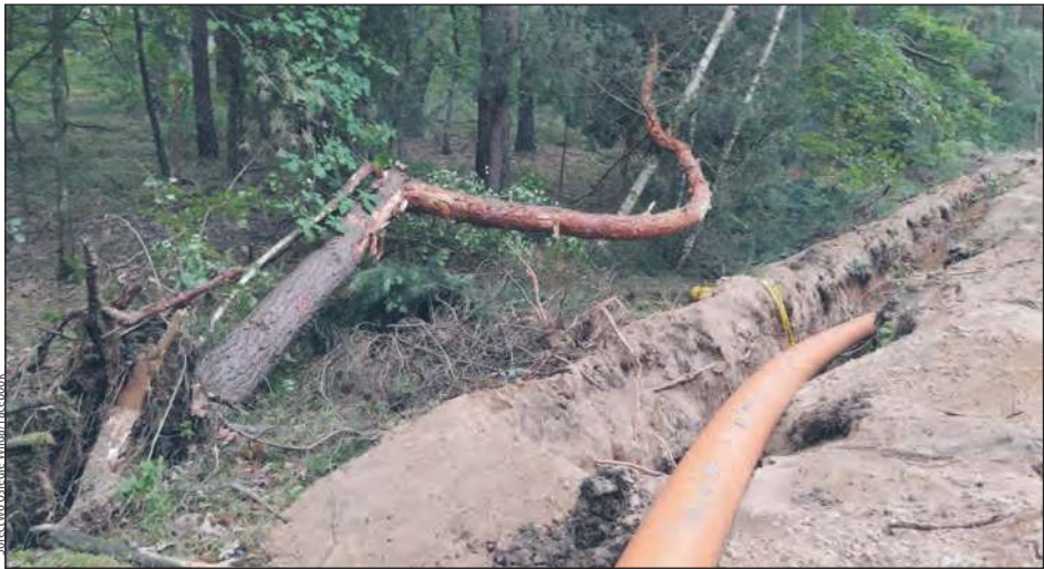
- Wycięte kolejne drzewa, zniszczenia wykraczające poza obris pobocza (choć pewnie nadal w pasie drogowym), niechlujny sposób zasypywania wykopów, przechowywanie rur na ulicach prostopadłych do Traktu Słonecznego i to w sposób, który także niszczy pobocza dróg i ulic Osiedla - wymieniał sołtys Marcin Olkiewicz
