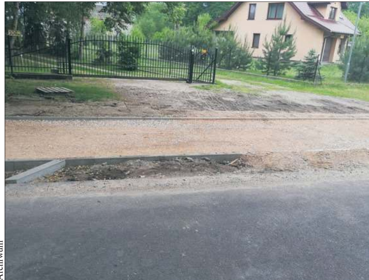
Na odcinku leśnym nie ma wybudowanych podjazdów
