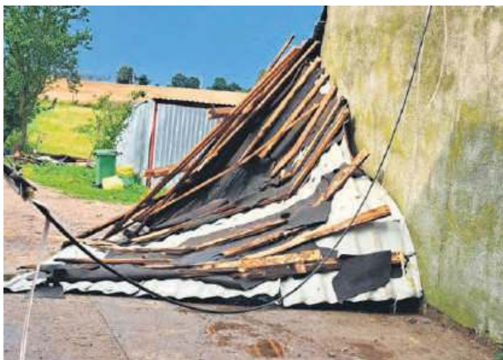
Różne elementy dachu rozpadły się na podwórku.
