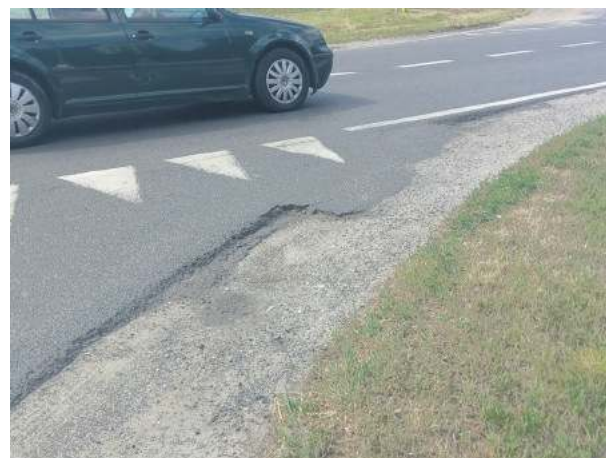
Ubytki asfaltu spowodowały niebezpieczny uskok
