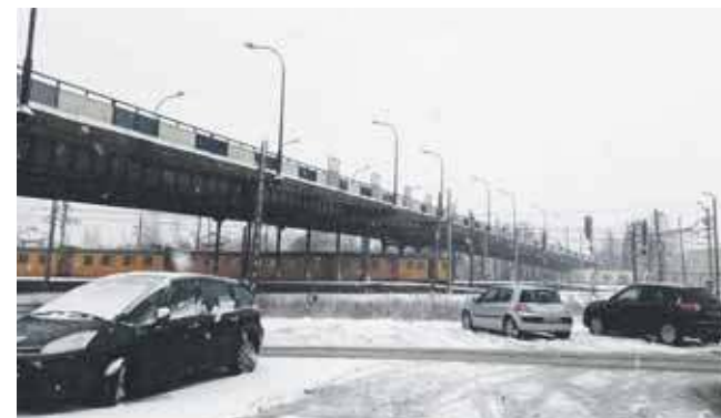
O remoncie wiaduktu na ul. Nakielskiej mówi się od lat. Problem to astronomiczne koszty
