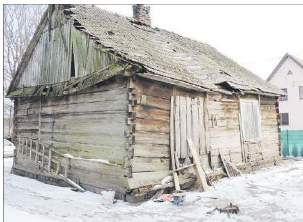
Stary, drewniany dom groził zawaleniem. Dach się zapadał i przeciekał, a w środku hulał wiatr
