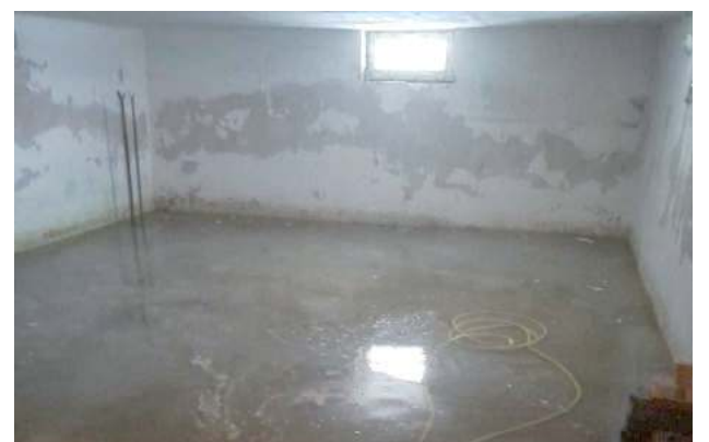
Radny Janusz Gnida bije na alarm, że w piwnicy remontowanej remizy w Lipowcu stoją wody gruntowe. - Wpadł na pomysł, jak zlikwidować kolejny budynek gminny, jakim jest remiza, żeby nie można było go użytkować w sposób nieuciągliwy – mówił radny o działaniach wójta
