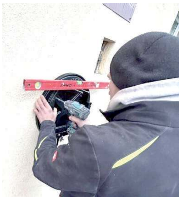
Defibrylator został zamontowany na ścianie remizy w Zamchu
