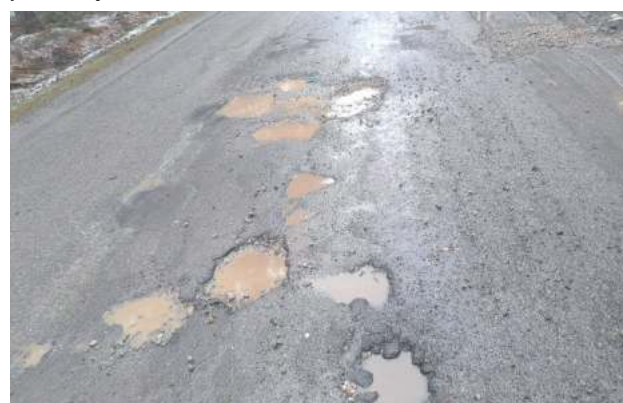
Droga na odcinku Tereszpól - Bukownica jest w opłakanym stanie. Mieszkańcy od lat proszą o jej remont
