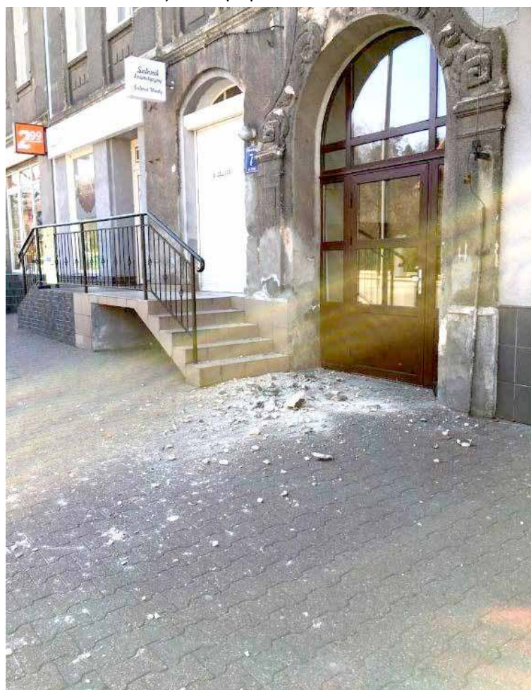
Z elewacji budynku przy ulicy Piłsudskiego 7 na chodnik spadły spore ilości gruzu
