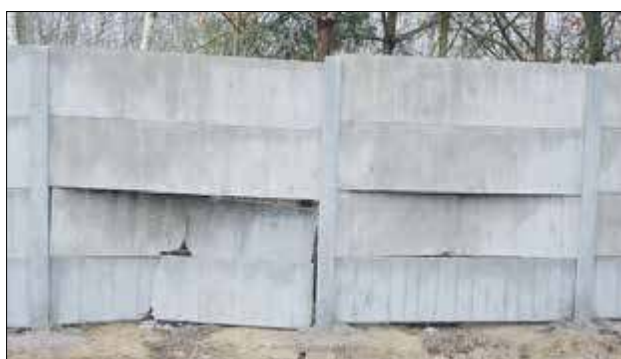
Betonowe przęsła młodzieńcy uszkadzili w grudniu ubiegłego roku
