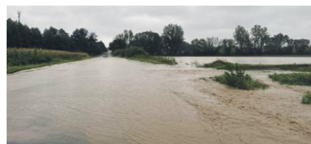
Po intensywnych opadach woda czasowo zalała drogę między Przewornem a Krzywinią
