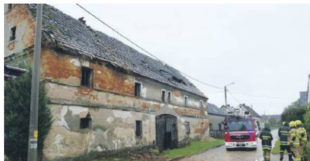
Cegły runęły na pobocze i drogę
