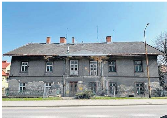
Budynek dawnego Zamku Żupnego w Bochni (marzec 2025). Budynek ciągle stoi pusty, grożąc zawaleniem
