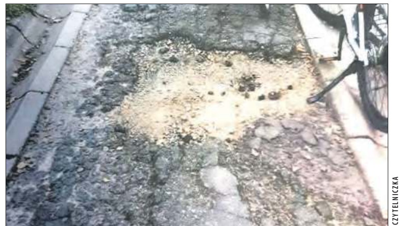
Zniszczona alejka cmentarna
