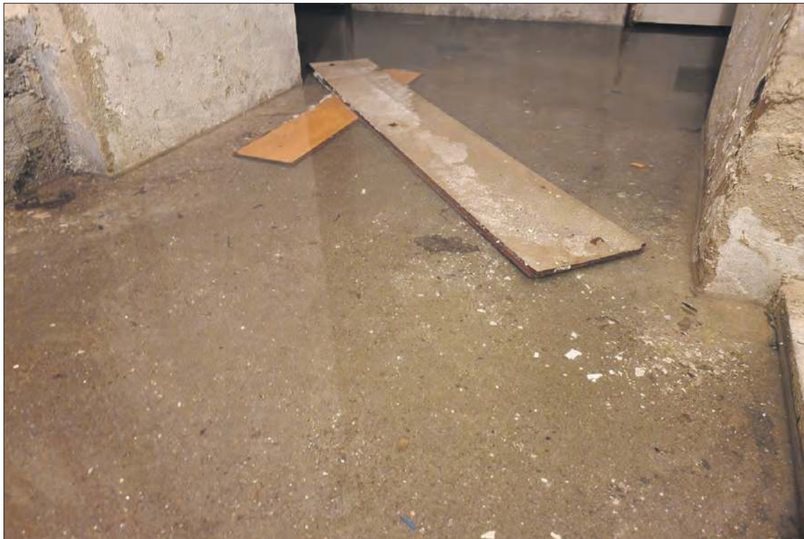
Woda w piwnicy
