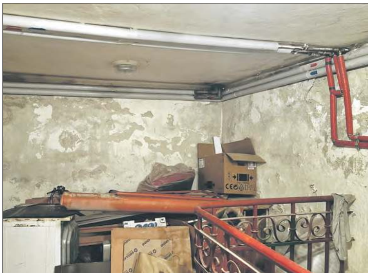
Zawilgocone ściany wewnątrz budynku
