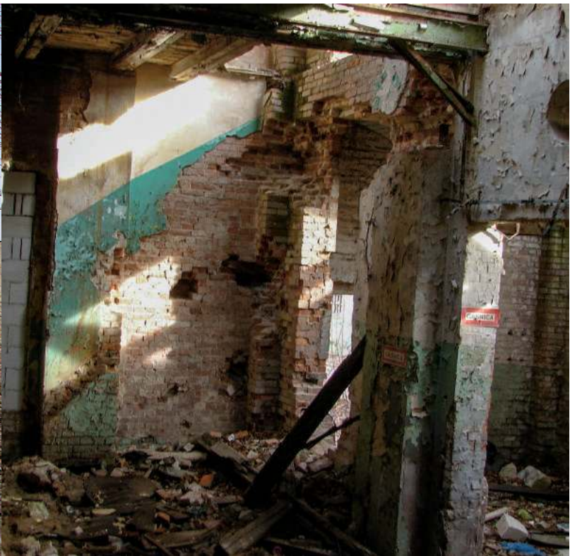
Elewacja budynku fabrycznego od strony ul. Stalowej i zrujnowane wnętrza zabytku | fot. Janusz Sujecki/Gazeta Polska
