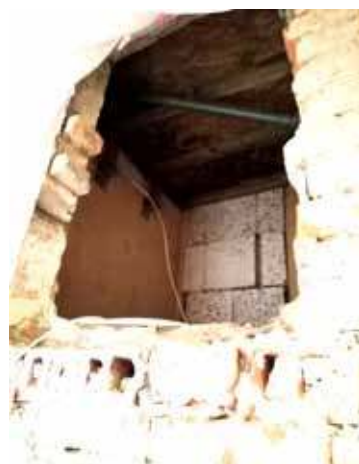
Wnęka w kuchni nad łazienką zwiędzona sufitem z płyty paździeżowej
