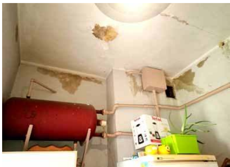
Zniszczony sufit w kuchni po zalaniu
