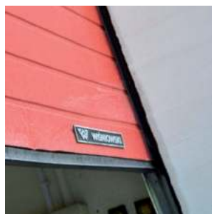
Uszkodzona brama garażowa
