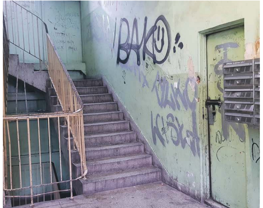
Widok klatki schodowej nie zachęca do wejścia do budynku
