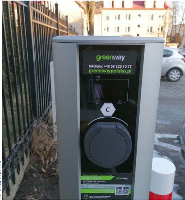
Stacja ładowania pojazdów stanęła na parkingu przy ulicy Sądowej w Chrzanowie. Ma być czynna w najbliższych tygodniach
