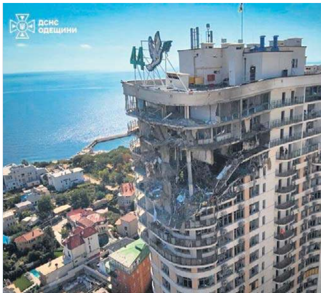
Rosjanie atakowali Odessę w nocy z soboty na niedzielę. Uszkodzono m.in. placówkę edukacyjną i wielopiętrowy budynek
