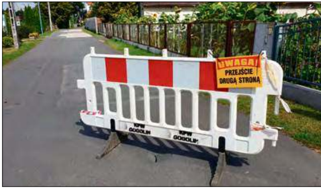
Po naprawie kanalizacji zostały dziury zasypane kamieniami i plastikowe barierki ostrzegawcze.
