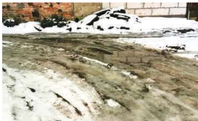
Pod wodą jest rozkopana ziemia a na poboczu pozostawiono zerwany asfalt
