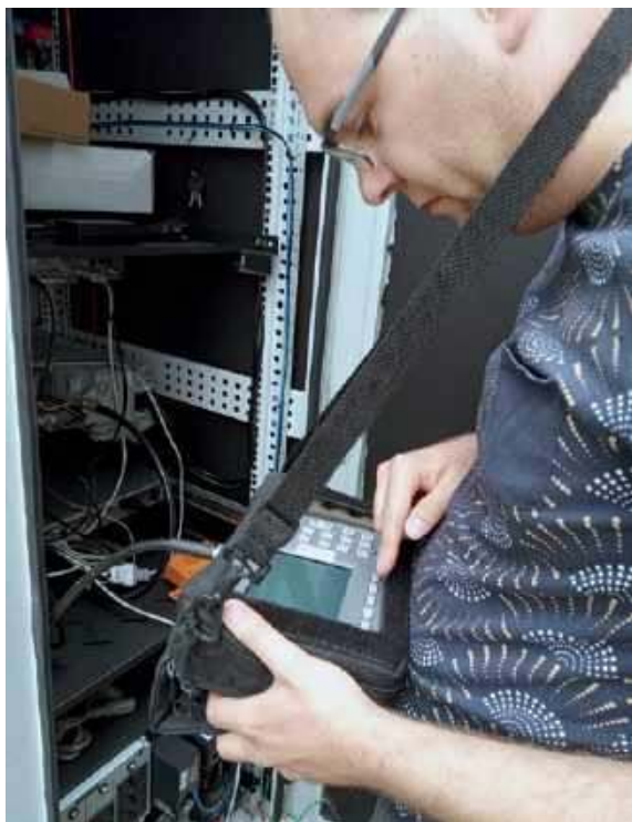
Wnętrze szafy SR5MS
