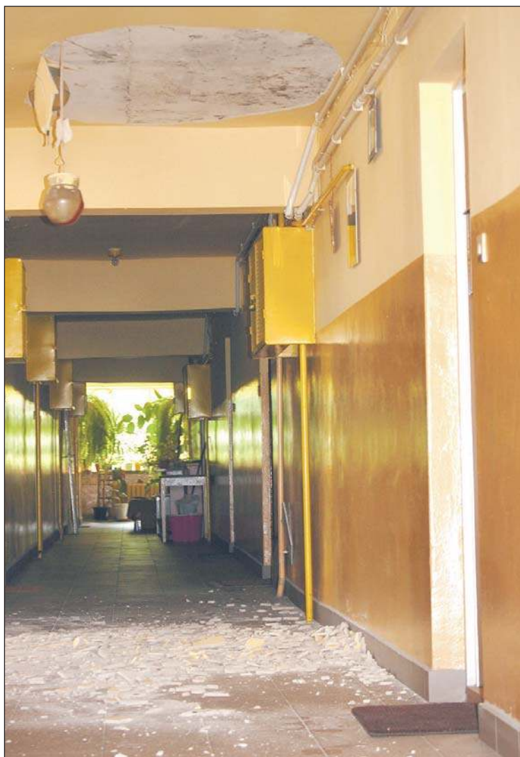
Tynk z sufitu odpadł na trzecim piętrze, przy Głowackiego 35.
