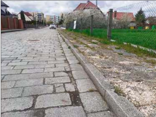
Droga i chodnik są w bardzo złym stanie, ale najbardziej doskwiera brak kanalizacji deszczowej.
