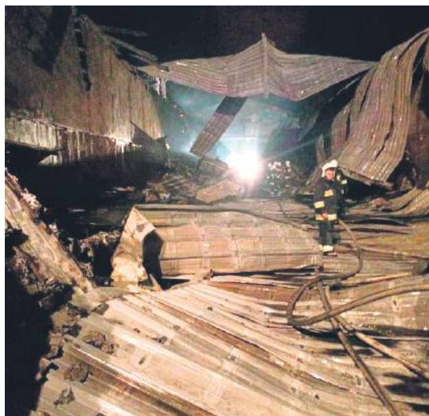
Spaleniu uległ dach budynku na powierzchni ok. 900 mkw.
