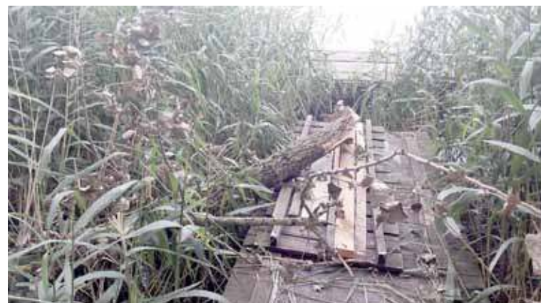
Ułamany spory konar topoli spadł wprost na kładkę. Na szczęście tym razem nikt nie ucierpiał
