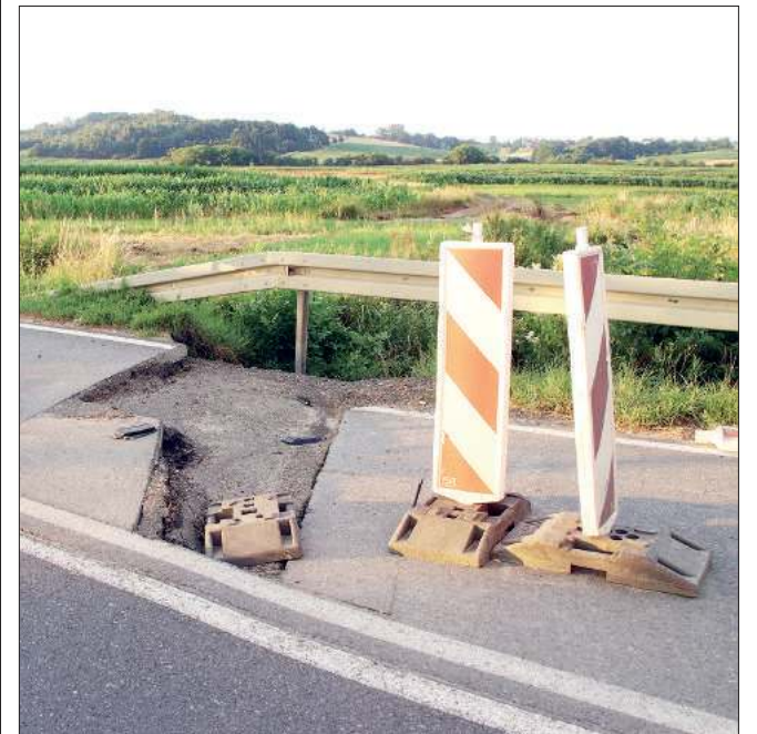
Aktualnie w ciągu ul. Granicznej w Lubomi, gdzie uszkodzeniu uległ jeden z przepustów, obowiązuje ruch wahadłowy
