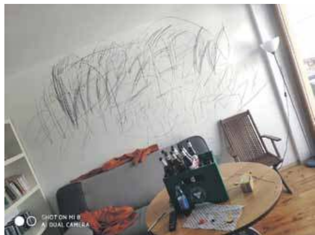
Goście pozostawili po sobie zniszczone ściany w apartamencie.
