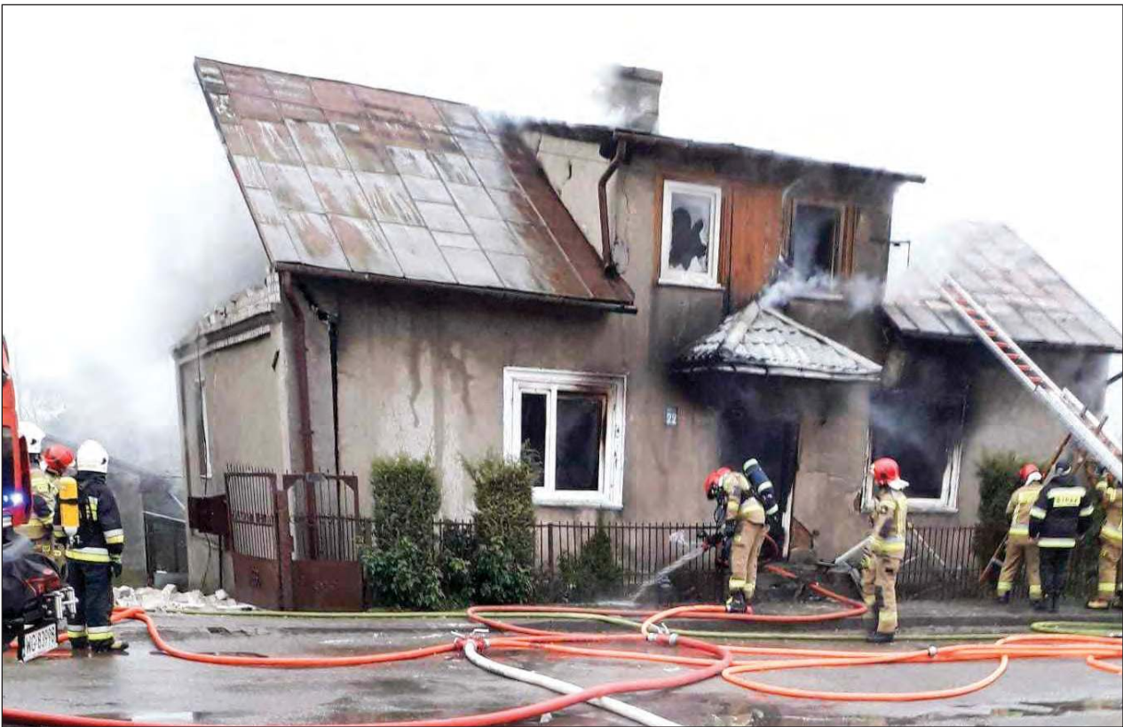
Do wybuchu gazu w budynku mieszkalnym doszło 1 grudnia o godzinie 12:30. Następstwem tego był pożar domu
