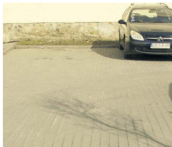
Nawierzchnia parkingu jest w wielu miejscach zapadnięta
