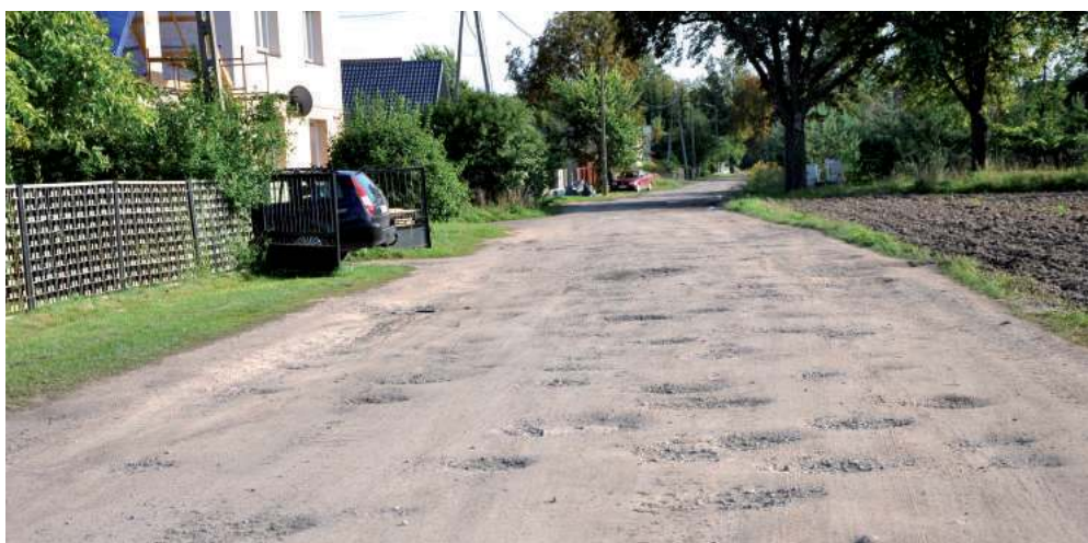
Gruntowa droga jest pełna głębokich dziur, które mogą wyrządzić szkody zawieszeniu auta, natomiast po deszczu tworzą się tam wielkie kałuże
