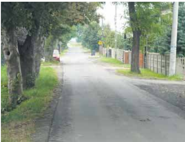
Na ul. Małej brak chodnika i porządnego pobocza
