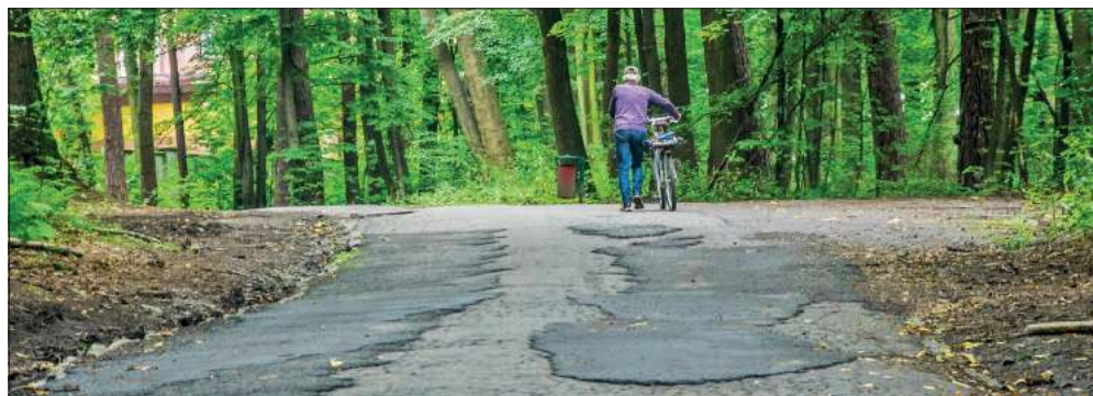
Dziury, uskoki, spękania i nierówności. Jedyna droga dojazdowa do Ośrodka Rekreacyjnego „Balaton” wymaga kapitalnego remontu.
