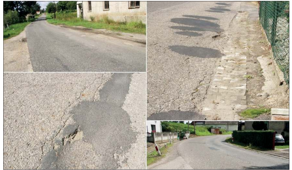
Bez dwóch zdań ul. Kozielska biegnąca przez centrum Brzeźnicy wymaga kompleksowego remontu.
