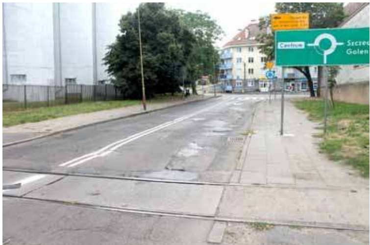
Na kiepski stan drogi na Kochanowskiego zwracaliśmy uwagę już w sierpniu. Jak widać sytuacja nie ulega tam poprawie, a jest nawet gorzej
