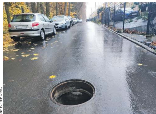
Wyrwany właz do studzienki na Parkowej w Krzeszowicach
