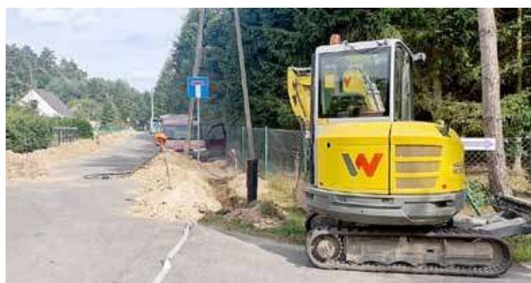
Pracownik tej minikoparki uszkodził rurę z gazem
