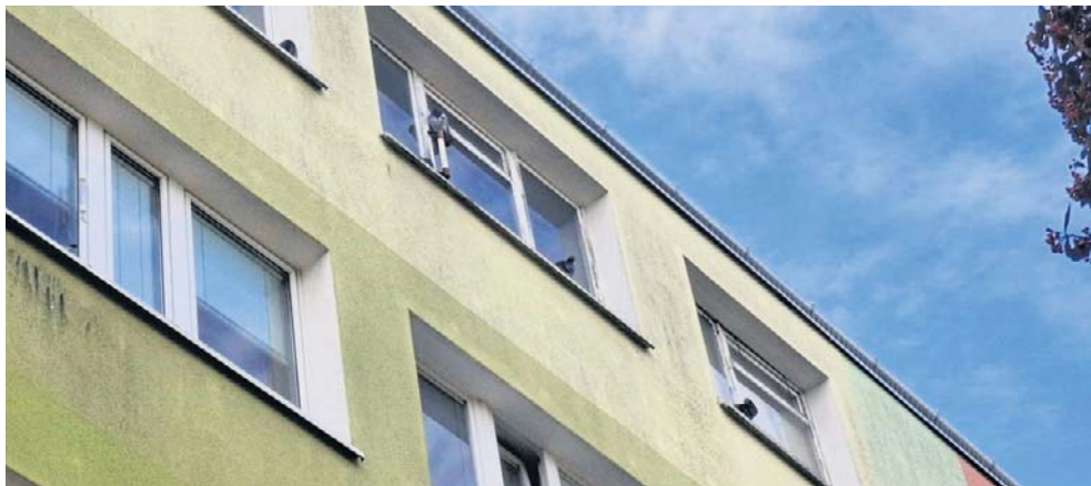
Sąsiad dokarmia ptaki. Gołębie siedzą na parapetach, a ich odchody i pióra są na szybach i parapetach
