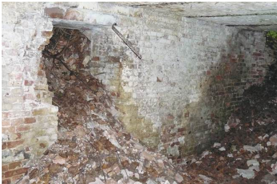
Stan piwnic dużego pałacu w Górze
