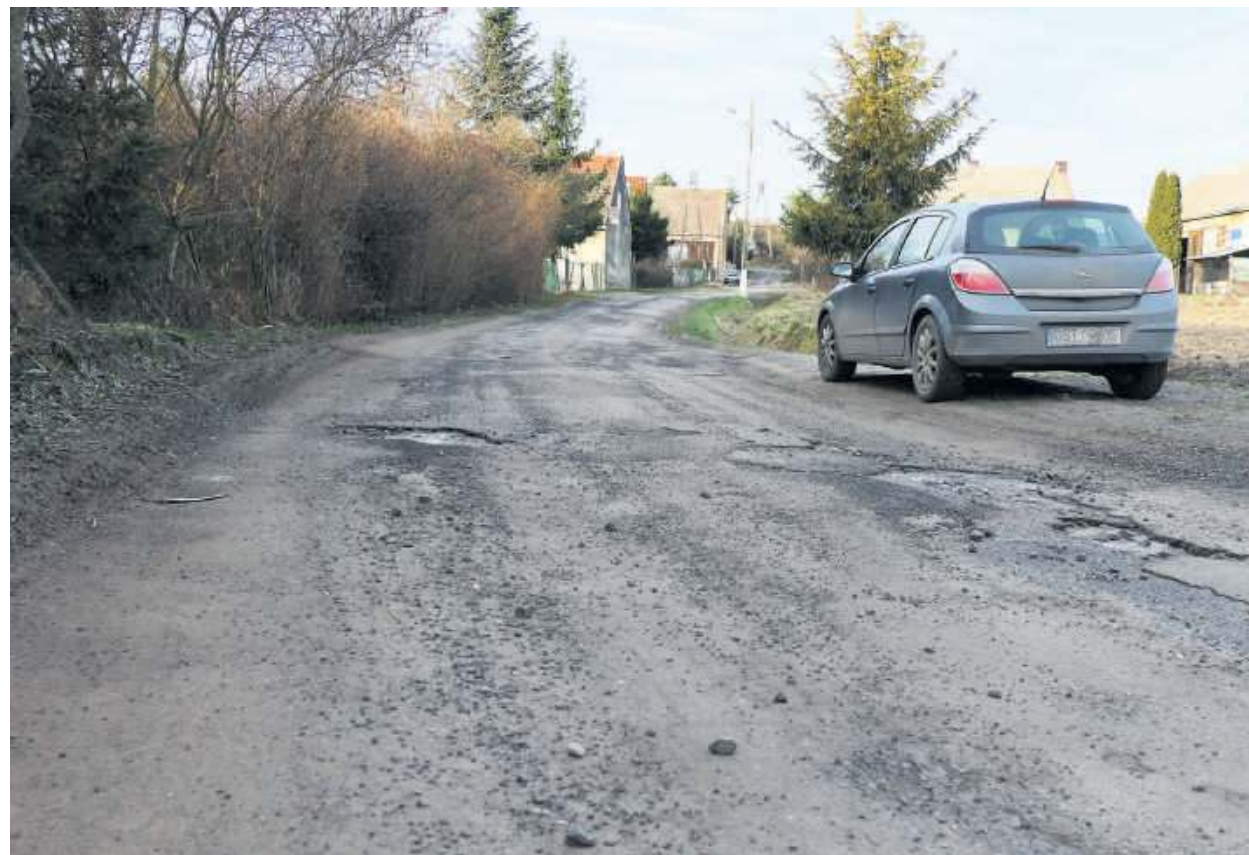
Dziury w nawierzchni drogi powiatowej Krzywina – Samborowiczki
