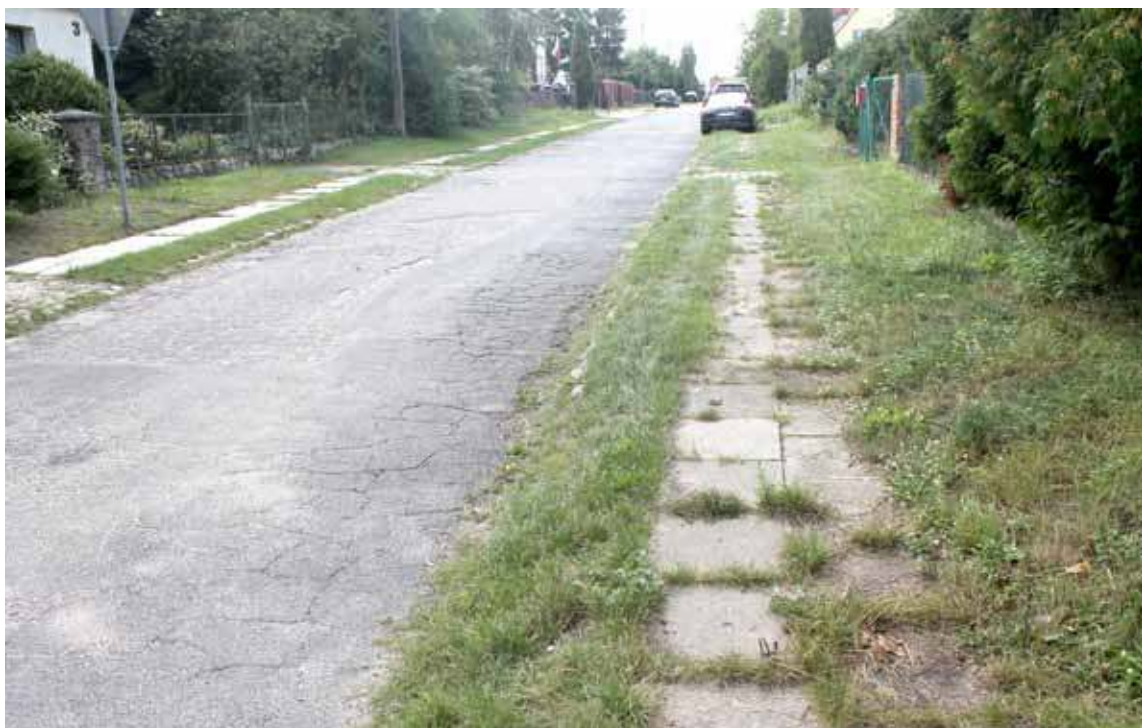
Zarówno nawierzchnia drogi jak i płyty chodnikowe są w złym stanie
