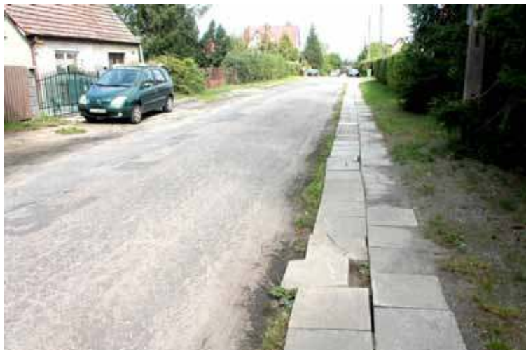
Niektóre płyty chodnikowe ulegają degradacji i zaczynają nieestetycznie wystawać poza krawędź chodnika
